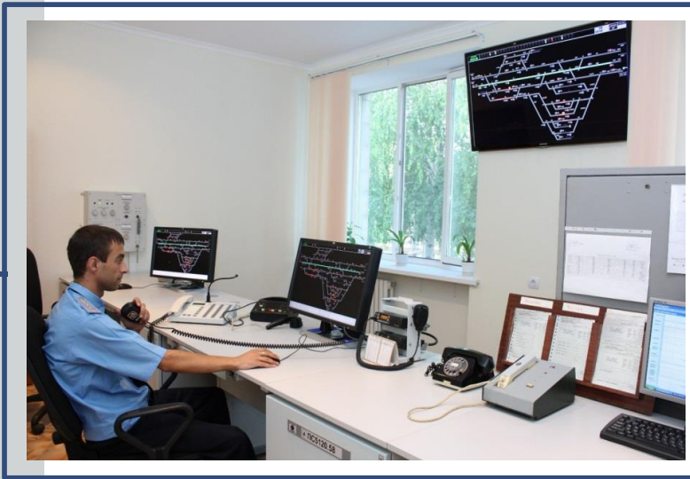
Рабочее место дежурного по станции (АРМ ДСП)
